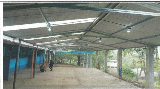
Foto 2: Iluminación de energía eléctrica en patio.
