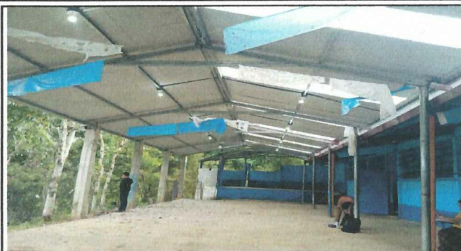
Foto 1: Iluminación de energía eléctrica en patio.
